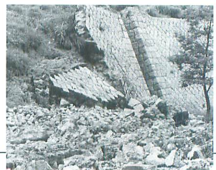
運動場北側擁壁崩壊
