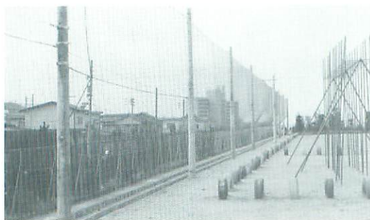
▲ 高さ6m 延長220m の防球ネット
